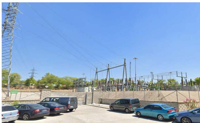
Figura 112. Subestación eléctrica en Las Rozas de Madrid
